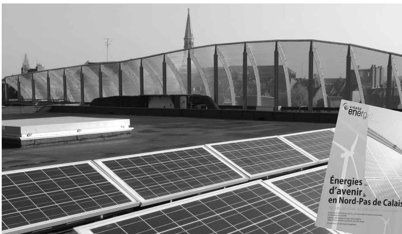
Panneaux Photovoltaïques à Lille ( www.virage-energie-npdc.org )
